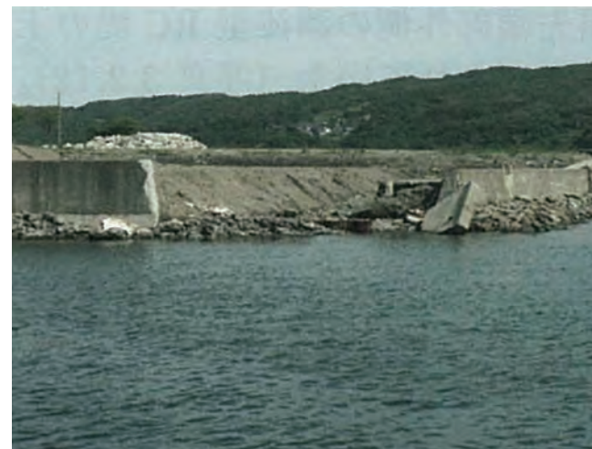
写真2.6.7 久慈漁港の被災状況 31)
