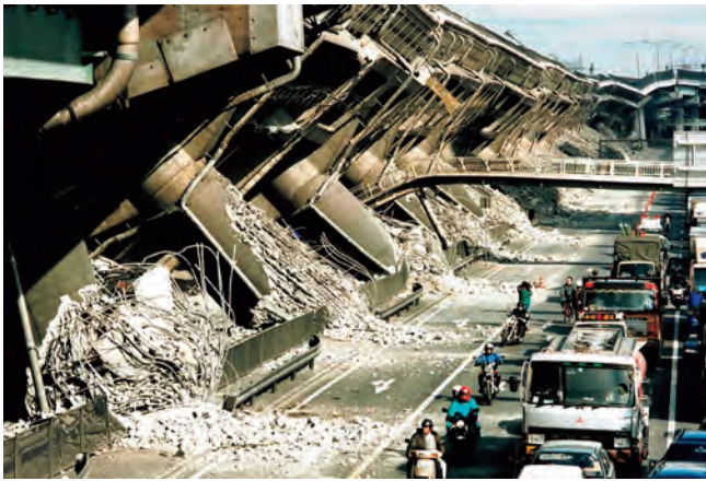
写真2.4.2 兵庫県南部地震(阪神・淡路大震災)の被災状況 10) (写真提供:神戸新聞社)
