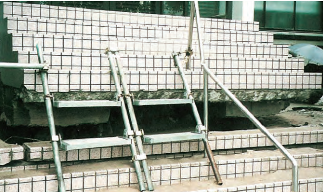
写真2.4.19 周辺地盤の沈下による階段のずれ 41)
