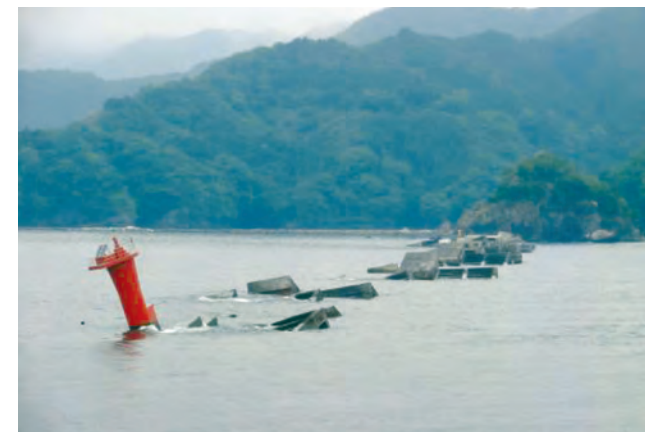
写真3.2.24 釜石湾口防波堤の被害
