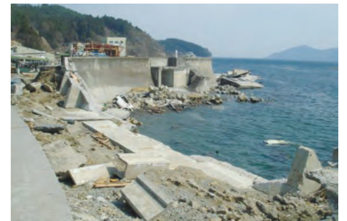
写真3.2.25 大船渡市三陸町の防潮堤被害
