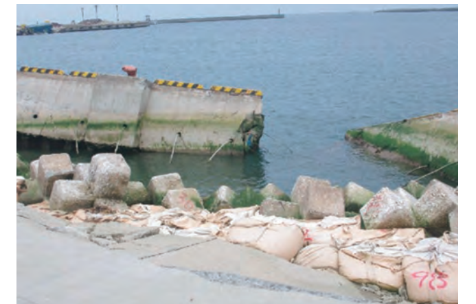
写真2.6.9 相馬港1号埠頭の被災状況 33)
