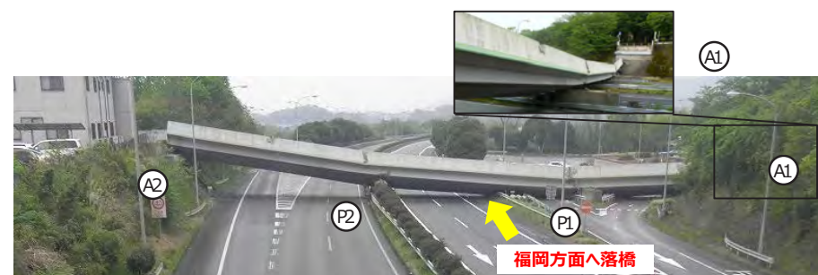
写真 3.2.33 府領第一橋の落橋状況
