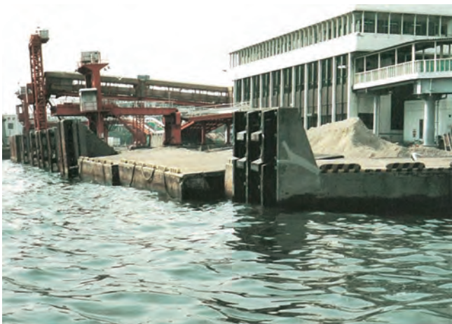
写真2.4.14 東神戸フェリー埠頭(ケーソン護岸が崩壊した岸壁の全景) 35)
