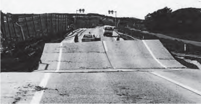
写真3.2.7 能代南バイパス被害状況（防災ネット東北(c) 東北地方整備局)
