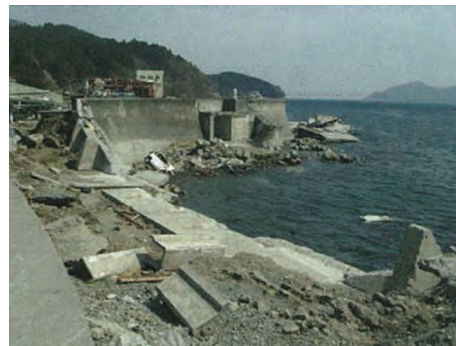
写真2.6.6 大船渡市三陸町の防潮堤被害 31)
