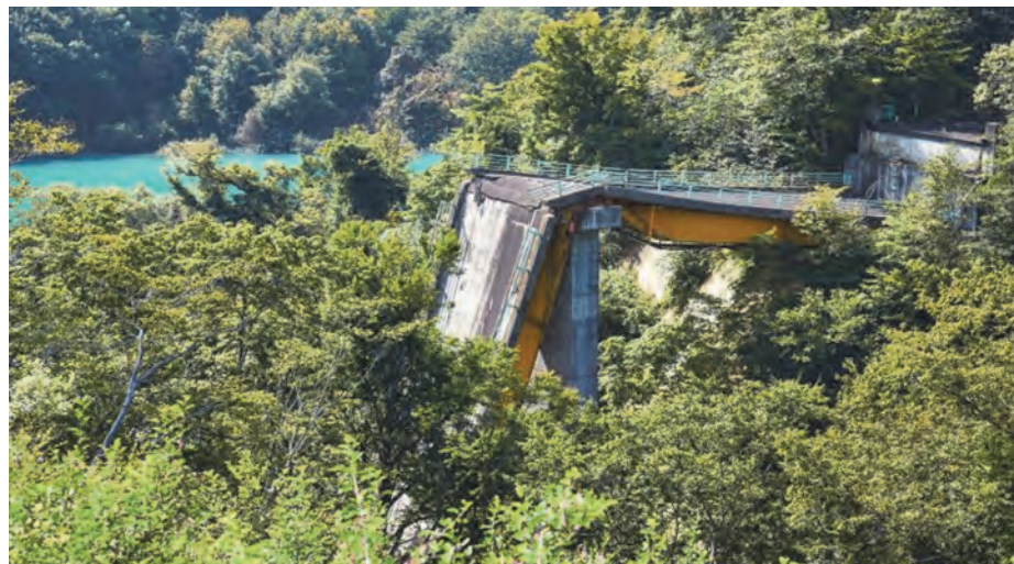
写真3.2.19 災害遺構として落橋したまま保存される旧祭時大橋
