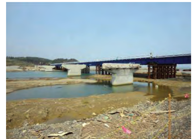
写真3.2.21 津波で上部工が流出した小泉大橋
