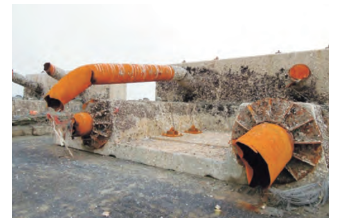
写真2.6.10 石巻漁港波除堤の被災状況 33)
