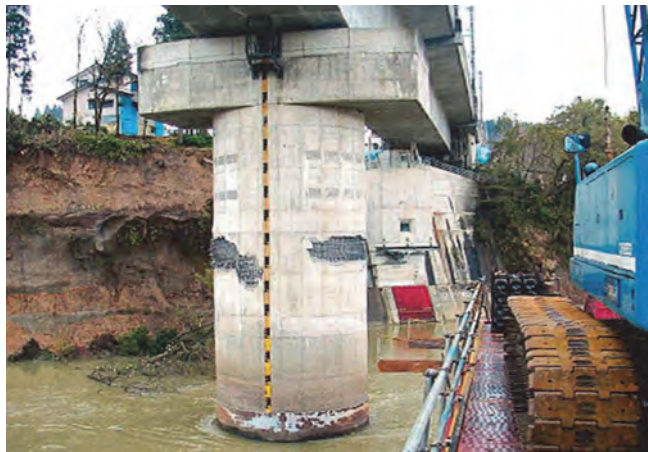
写真3.2.16 橋脚の被災状況
