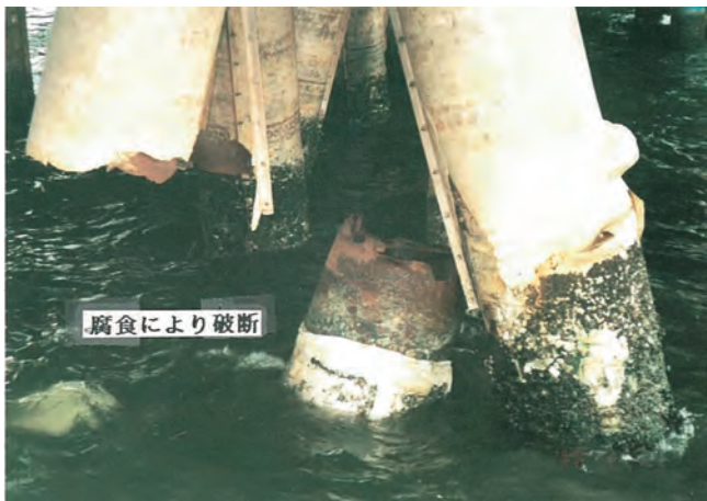
写真2.4.13 住吉浜町のサイロ岸壁(腐食により破断したと思われる鋼管杭) 35)
