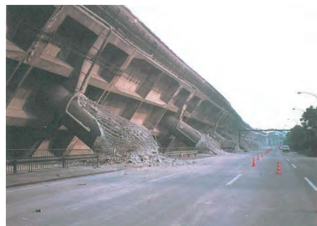
写真2.4.5 兵庫県南部地震(阪神・淡路大震災)での阪神高速神戸線の高架橋の倒壊(神戸市東灘区深江地区) 23)
