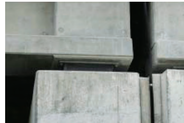
写真3.2.22 支承部の変形
