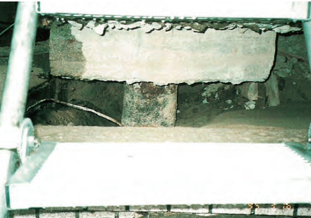
写真2.4.20 露出し傾斜した鋼管杭 41)
