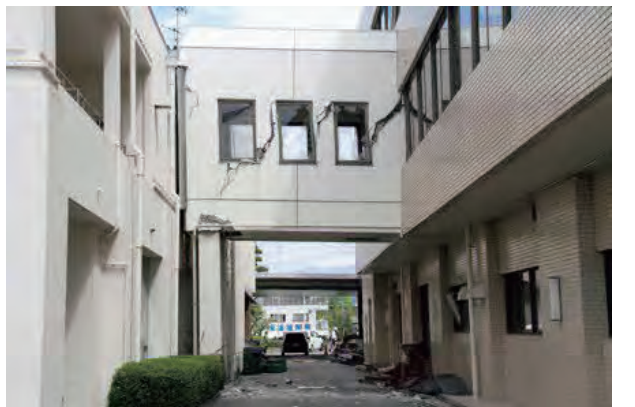
写真2.6.22 熊本地震で被災した庁舎建物 48) (写真提供: 熊本県益城町)
