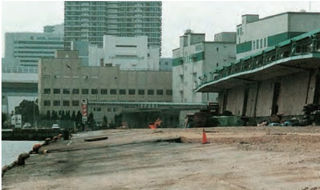
写真2.4.17 ケーソン岸壁の前傾による、鋼管杭基礎と構造物の傾き 41)
