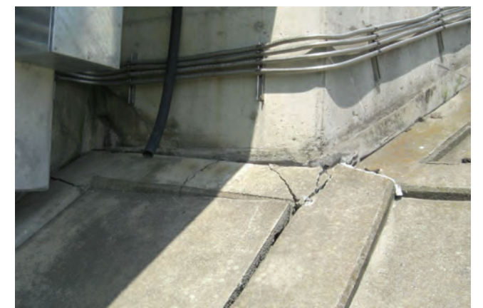
写真3.2.23 橋台法面のひび割れ
