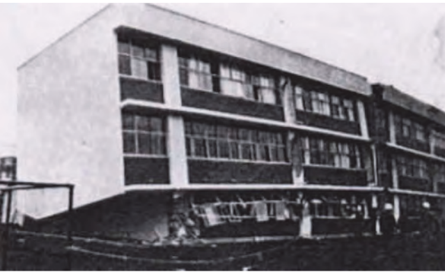
写真3.2.4 三沢商業高校、1階柱せん断破壊(防災ネット東北(c) 東北地方整備局)
