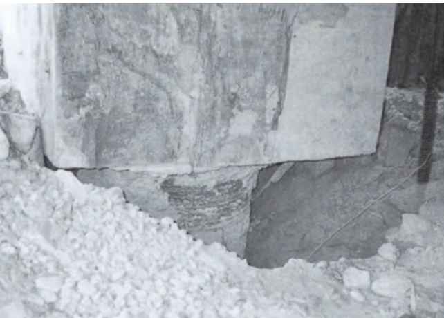
写真3.2.12 臨海部倉庫の露出した鋼管杭の杭頭部 〔周辺地盤が沈下し、杭頭部が露出していたが、外観上は鋼管杭に変状はみられない〕
