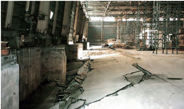
写真2.4.18 フーチングの移動により陥没した床版 41)
