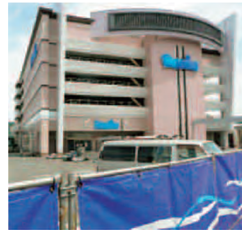
写真2.6.19 宮城県石巻市内の被災建物(遊戯施設) 45)
