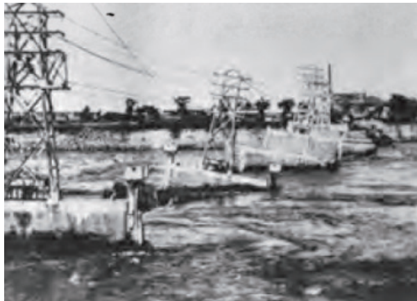
写真2.1.11 宮本武之輔氏と陥没した信濃川大河津自在堰 56) (写真提供：信濃川大河津資料館)
