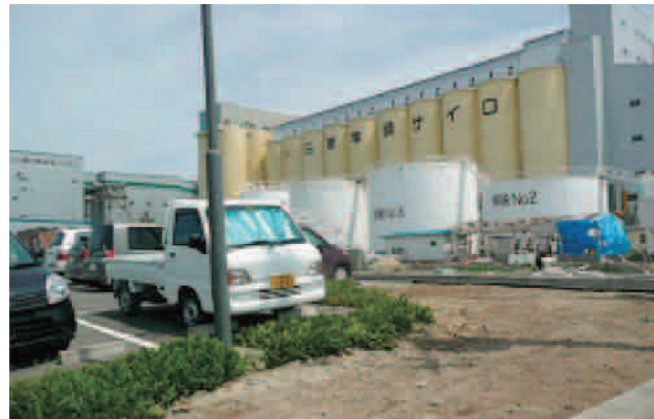
写真2.6.19 宮城県石巻市内の被災建物(原料サイロ) 45)
