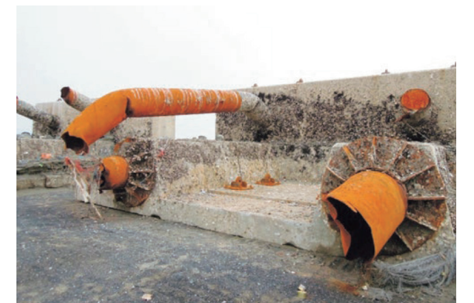
写真2.6.10 石巻漁港波除堤の被災状況 33)
