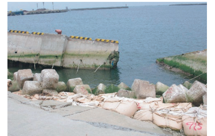
写真2.6.9 相馬港1号埠頭の被災状況 33)
