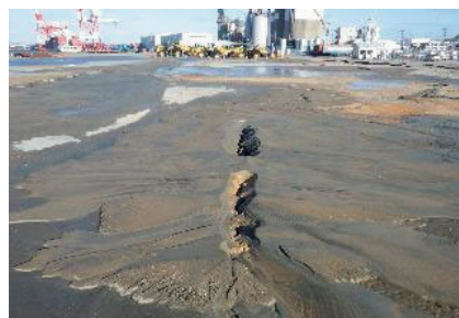
■ 金沢港・戸水ふ頭の被災状況 (液状化による噴砂)
