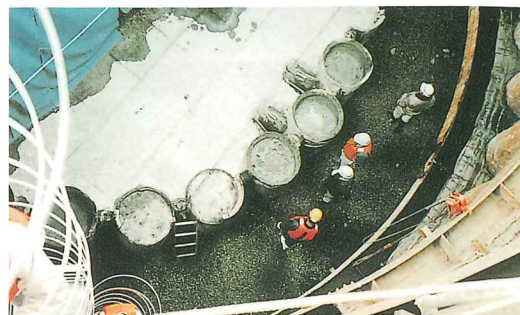
頂版コンクリートのクラック調査の様子
