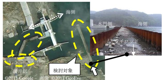
写真1 下荒川水門二重鋼矢板壁 被災状況
