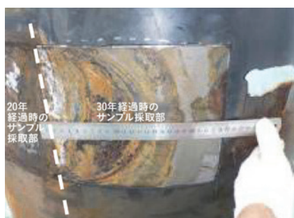
写真2 接着劣化進展距離測定状況 (No.31)
